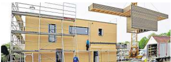
Präzise wird das 4,5 Tonnen schwere Modul an seinen Platz passgenau an die Hauswand angefügt. Die Abdichtungen gegen Witterungseinflüsse wurden bereits in der Werkhalle vorbereitet.
